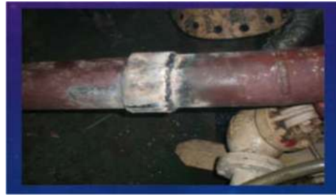
Gambar 9 Korosi Galvanis (Tretheway, Korosi untuk mahasiswa dan rekayasawan , 1991)
