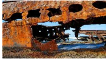
Gambar 5 Korosi erosi pada jembatan yang ada pada bibir pantai (Femiana Gapsari, Pengantar Korosi )
