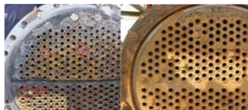
Gambar 2. Korosi akibat air ketel
