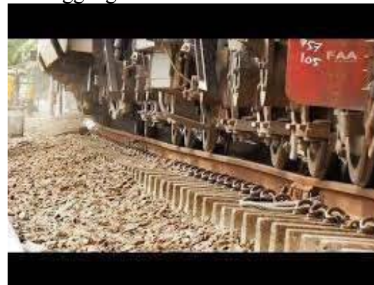
Gambar 6. Rel yang tidak rata
